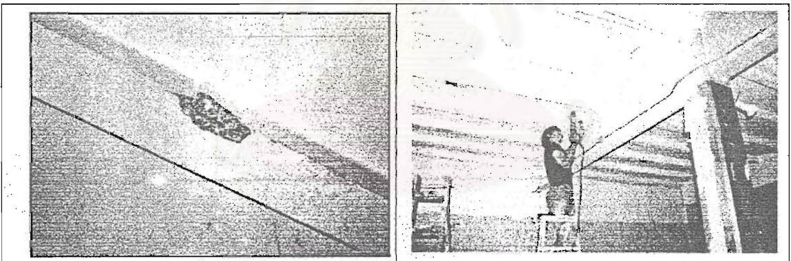
ภาพที่ 3-31 การสกัดและเจาะตงพื้นสำเร็จระหว่างก่อสร้างจนตงเกิดถูกทำลายบางส่วน
