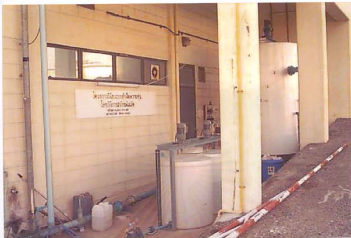
รูปที่ ๑ 2 สถานที่ทดลอง อยู่หลังโรงสูบน้ำดิบ 1
