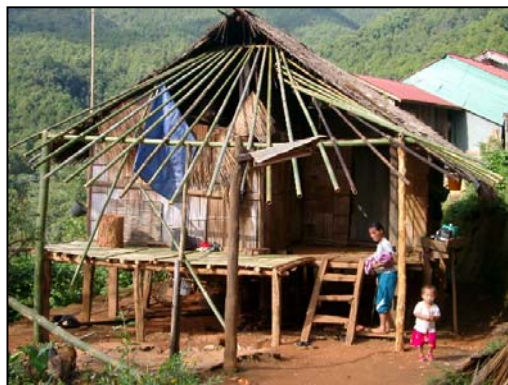
รูปที่ 5.61 ปัญหาวัสดุถุงหลังคาและพื้นหมดสภาพ
