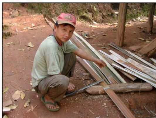
รูปที่ 5.12 เตรียมไม้ไผ่เพื่อซ่อมแซมสวนพื้นและผนัง
