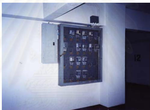
ภาพที่ 3.7 แสดงภาพถ่าย แผงมิเตอร์ไฟฟ้า
