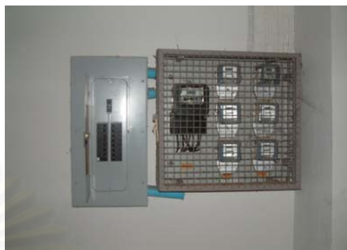
ภาพที่ 3.6 แสดงภาพถ่าย แผงมิเตอร์ไฟฟ้า
