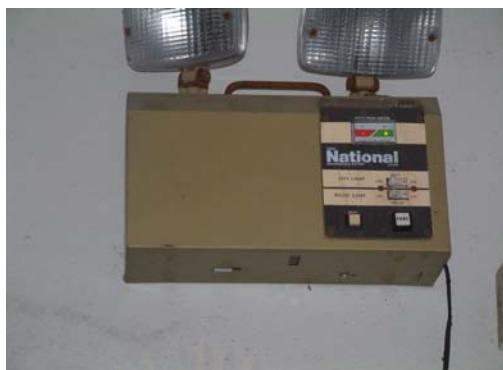
ภาพที่ 3.8 แสดงภาพถ่าย ระบบไฟฟ้าแสงสว่างฉุกเฉิน
