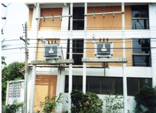
ภาพที่ 3.5 แสดงภาพถ่าย หม้อแปลงไฟฟ้า
