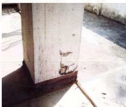
ภาพที่ 3.4 แสดงภาพถ่ายสภาพเสาคอนกรีตบริเวณลานจอดรถ
