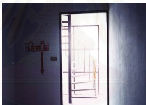
ภาพที่ 3.21 แสดงภาพถ่าย บันไดหนีไฟ
