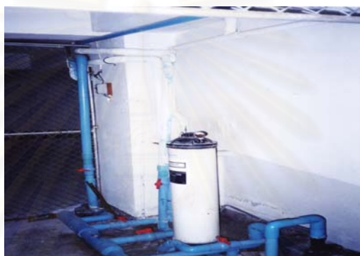
ภาพที่ 3.24 แสดงภาพถ่าย ระบบกรองน้ำในสระว่ายน้ำ
