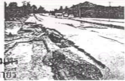
สภาพทางหลวงในเขตจังหวัดชุมพรที่มีปัญหาที่เกิดจากดินน้ำท่วมหนัก
