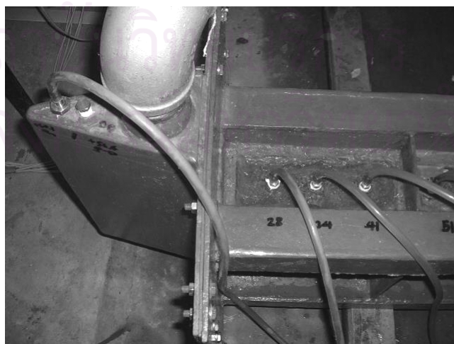
รูปที่ ง-26 การติดตั้งสายยางวัดระดับความดัน
