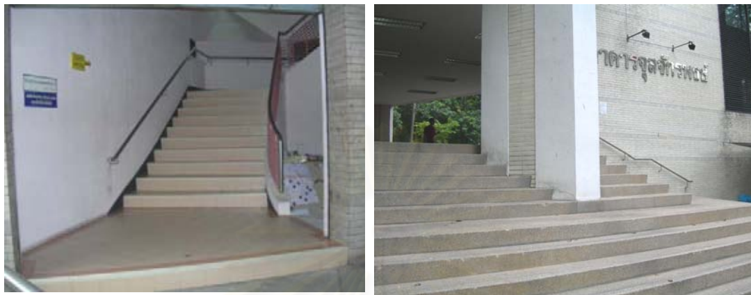
รูปที่ 4.61 บันไดภายในและบันไดภายนอกอาคาร
