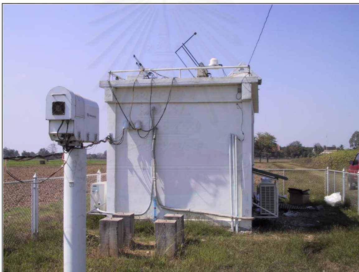
รูปที่ 3.6 ลักษณะการติดตั้งการรับข้อมูลของเครื่องไมโครเวฟเรดิโอมิเตอร์ ที่สถานีศรีสำโรง
