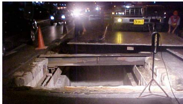
รูปที่ 2.23 บ่อตันที่อยู่กลางถนนในกรุงเทพฯ
