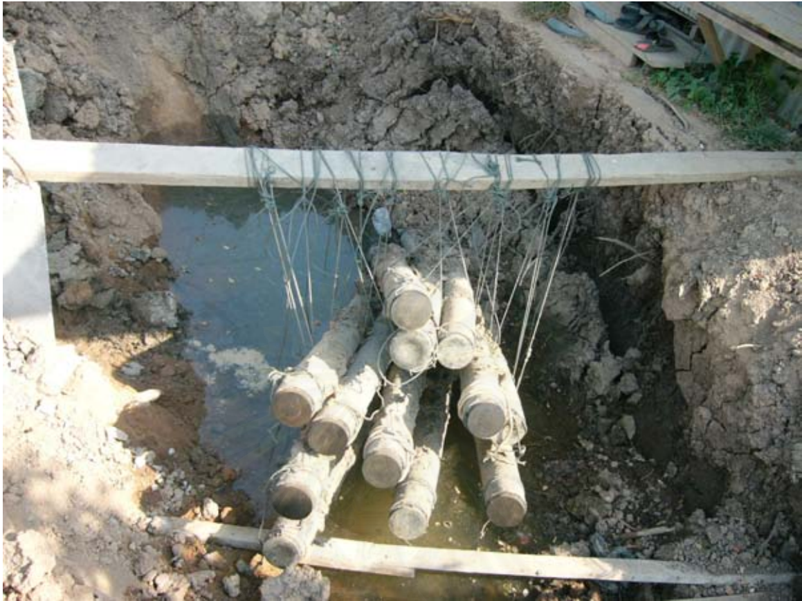
รูปที่ 1.2 กลุ่มท่อร้อยสายไฟฟ้าใต้ดินที่เกิดความเสียหายจากการก่อสร้างคันทาง
