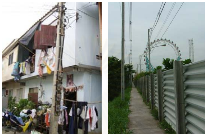
ภาพที่ 4.11 ระบบไฟฟ้าในชุมชนคลองลำนูน (จากการสำรวจ, 2549)
