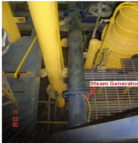
รูปที่ 3.7 อุปกรณ์ผลิตไอน้ำ (Steam Generator)
