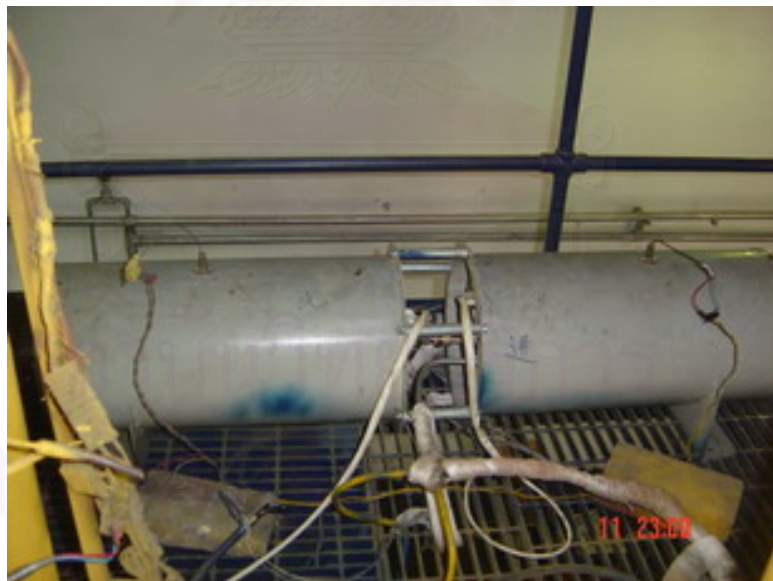
รูปที่ 3.8 ระบบอุ่นอากาศ (Air Preheater)
