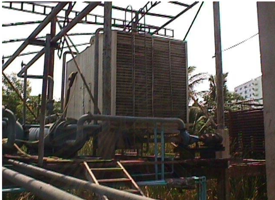
รูปที่ ๓.5 เครื่องควบแน่น
