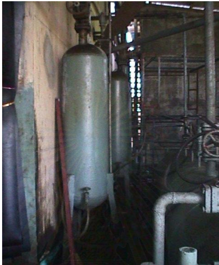
รูปที่ น.3 ถังแยกน้ำมัน
