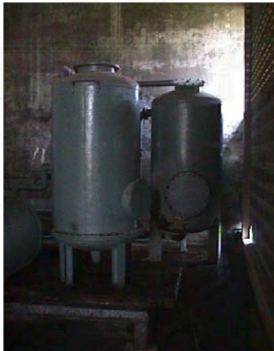
รูปที่ ๓.6 ถังเก็บน้ำดิบ
