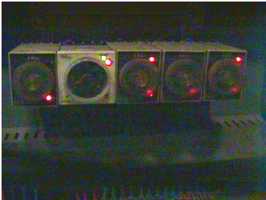
รูปที่ น.8 แผงหน้าปัดควบคุมเครื่องทำน้ำแข็งหลอด
