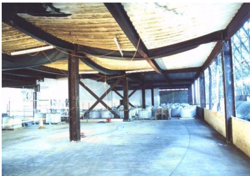
รูปที่ 2-3 การแอ่นตัวและการบิดตัวของเหล็กรูปพรรณภายหลังการเกิดไฟไหม้
