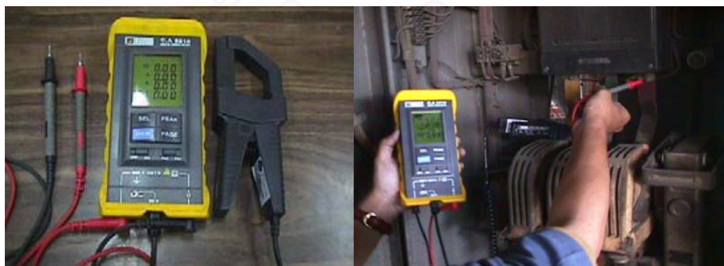
รูปที่ 6.5 อุปกรณ์วัดกำลังไฟฟ้า
