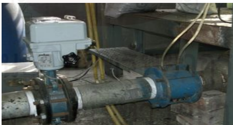
รูปที่ 3.8 วาล์วควบคุมแบบผีเสื้อและ orifice
