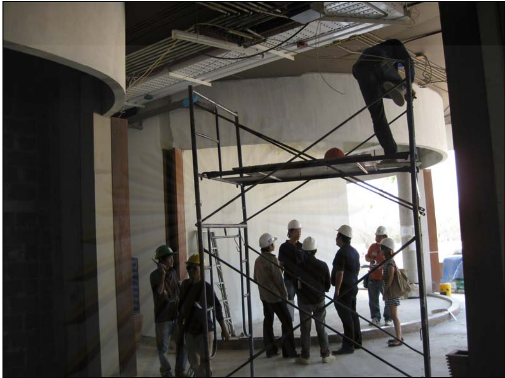
รูปที่ 3.8 การเตรียมความพร้อมด้านระบบไฟฟ้า
