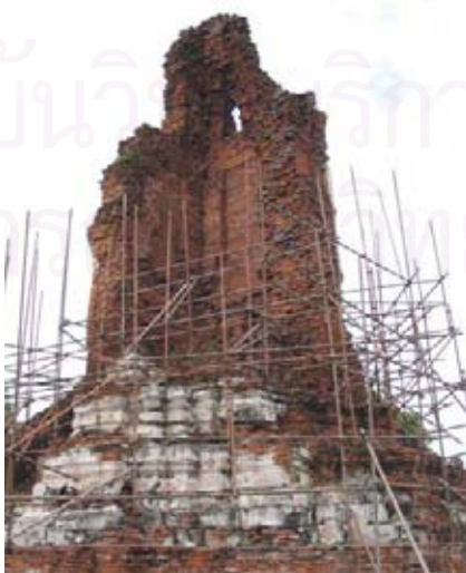
รูปที่ 5.28 โครงอิฐก่อรูปกากบาทภายในเจดีย์วัดมหาธาตุ (ขณะทำการบูรณะ)
