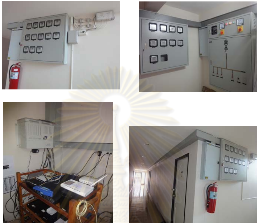
ภาพที่ 4.29 แสดงงานระบบไฟฟ้า
