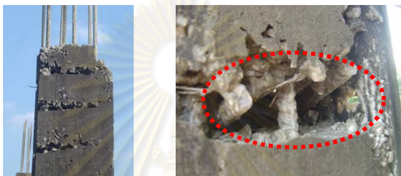
ภาพที่ 4.27 แสดงปัญหาการหล่อเสาคอนกรีต
