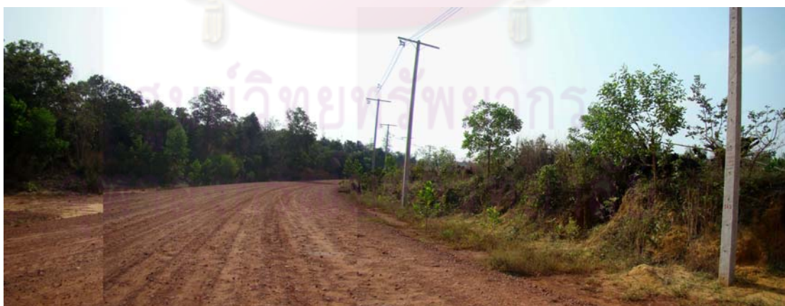
รูปที่ 3.51 แสดงถนนที่กำลังทำการก่อสร้าง ซึ่งทำการตัดผ่านบริเวณหลังเนินทรายลูกที่ 2 ของกรมทางหลวงชนบท โดยจะทำการยกเลิกใช้เส้นทางถนนที่ตัดผ่านเลียบชายหาดบางเบ็ด เมื่อสร้างเสร็จ
