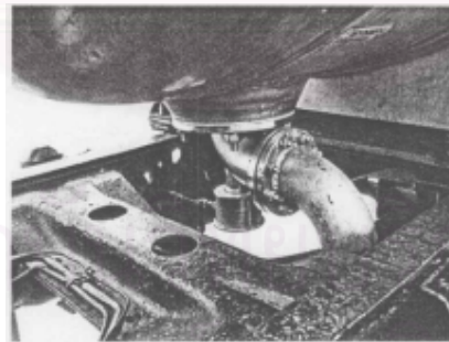
รูปที่ 4.2 วาล์วใต้ห้องรถ
