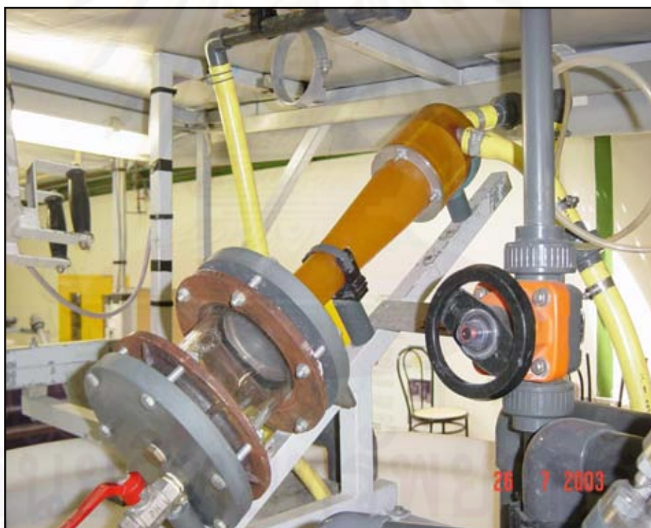
รูปที่ 3.3 ไฮโดรไซโคลนขนาดเส้นผ่านศูนย์กลาง 50 มิลลิเมตร ที่ติดตั้งกริตพอท
