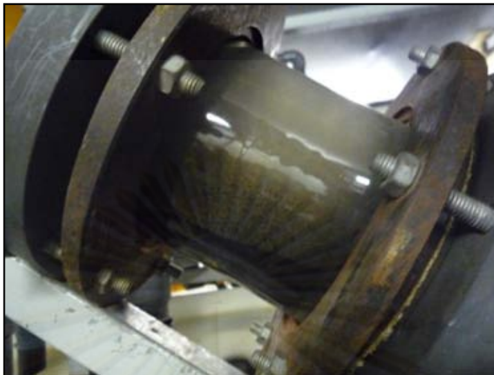
รูปที่ 4.9 ลักษณะของของแข็งที่ตกตะกอนและสะสมอยู่ในกริตพอท
