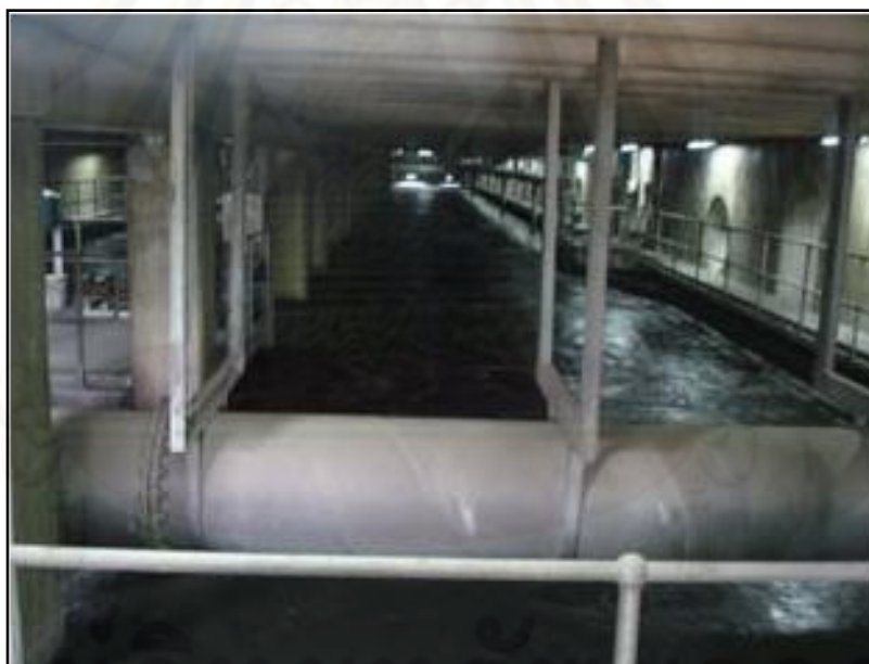
รูปที่ 2.4 ถังเลี้ยงตะกอน (Activated Sludge Tank)
