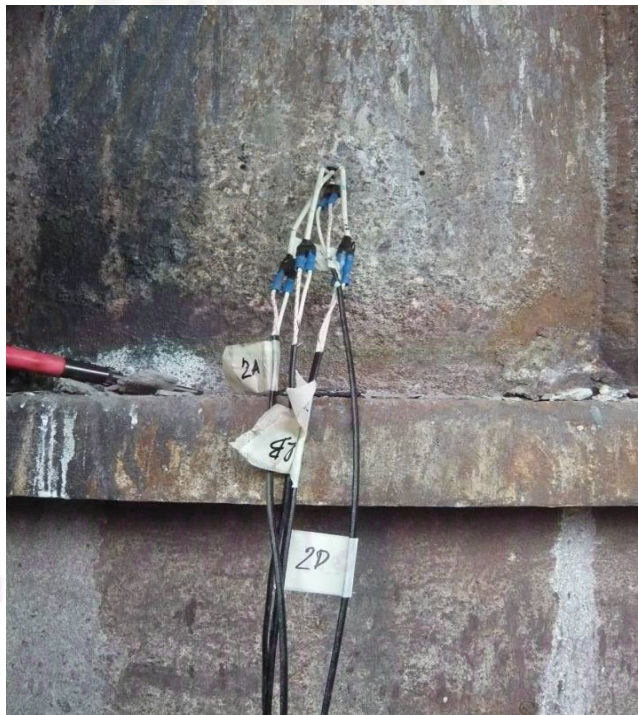
รูปที่ 4.10 ลักษณะของการติดตั้งเทอร์โมคัปเปิลในผนังของถังถ่ายน้ำเหล็ก
