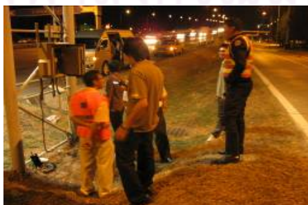
(c) ติดตั้ง DVR ที่ EXAT6 และปรับแก้การตั้งค่าอุปกรณ์
