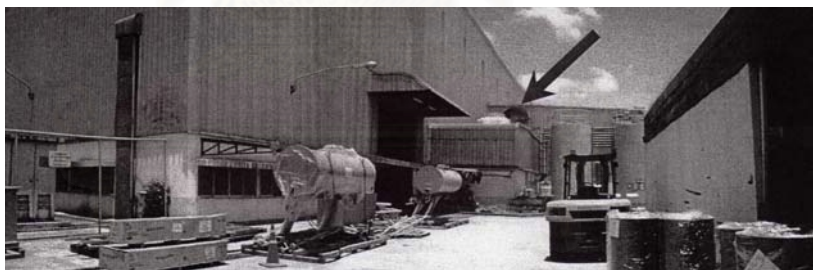
รูปที่ 3.24 เครื่องทำน้ำเย็น (Packed Air Cooled Chiller)
