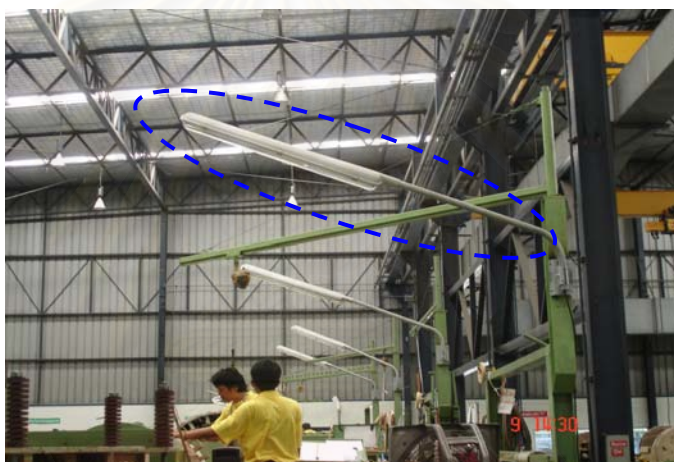
รูปที่ 4.13 หลอดไฟแบบ โคม Fluorescent
