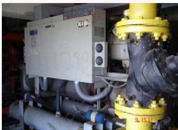
รูปที่ 3.27 Chiller 2 (CH-2)
