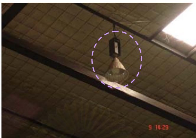
รูปที่ 4.12 หลอดไฟแบบ โคม Hi-bay
