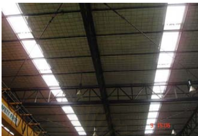
รูปที่ 4.14 ปิดหลอดไฟในบางส่วนในบริเวณที่สามารถใช้แสงสว่างจากดวงอาทิตย์ได้โดยตรง
