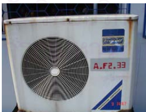
รูปที่ 4.9 เครื่องปรับอากาศ
