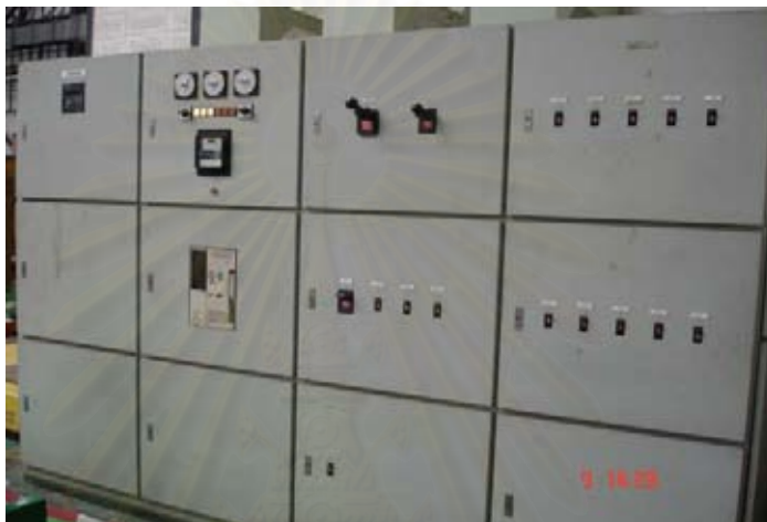
รูปที่ 3.2 ตู้ควบคุมระบบไฟฟ้า (Main Distribution Board)
