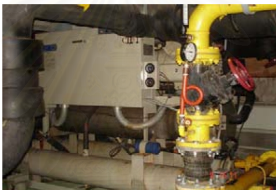
รูปที่ 3.26 Chiller 1 (CH-1)
