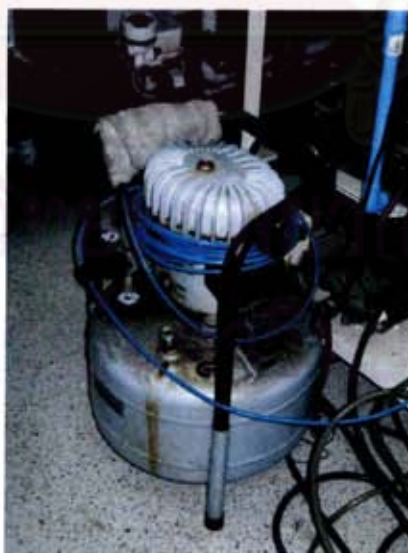
รูปที่ ก.2 เครื่องอัดลม
