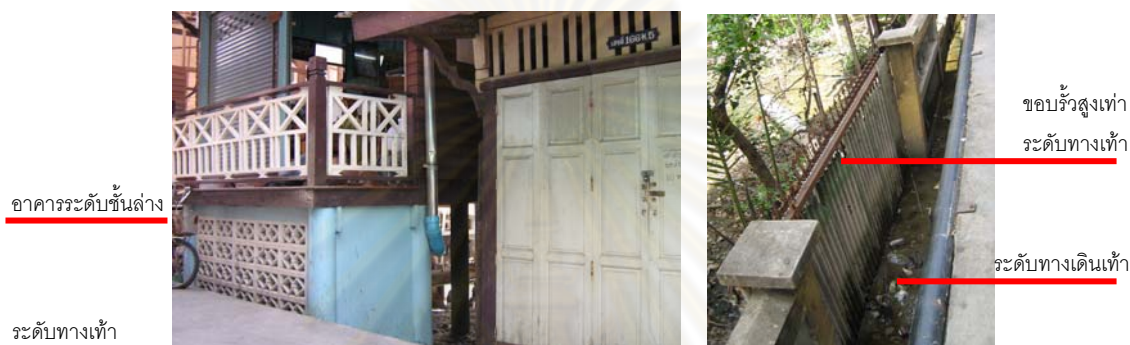
ระดับทางเดินเท้าที่ไม่เท่ากับระดับทางเข้าอาคารที่พักอาศัย
