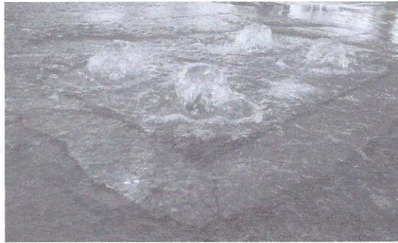
ภาพที่ 2-17 น้ำไหลเข้าบ่อพักระบายน้ำ
