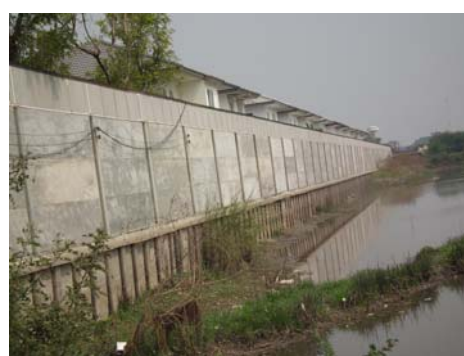
ภาพที่ 6-12 รูปถ่ายรั้วเขื่อนโครงการติดบ่อน้ำ
