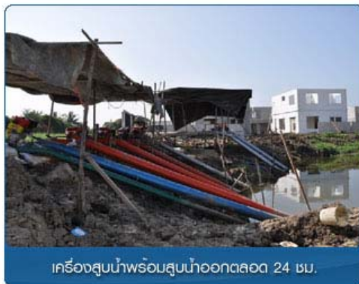
ภาพที่ 5-74 รูปถ่ายเครื่องสูบน้ำแรงระบายน้ำ
