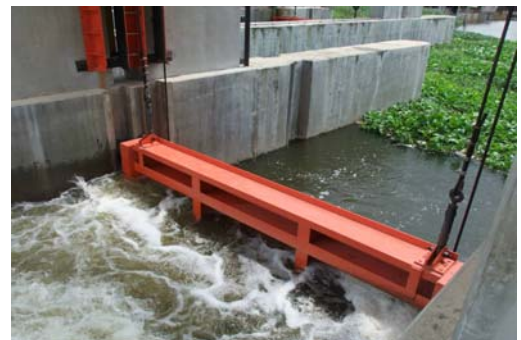
ภาพที่ 5-15 รูปถ่ายประตูระบายน้ำ
