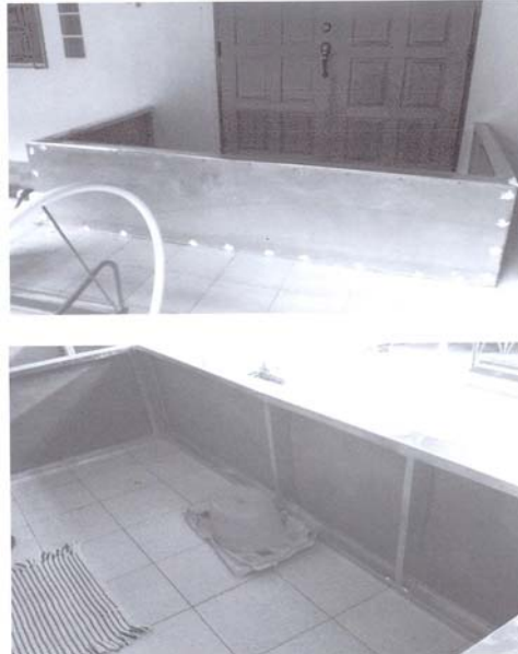
ภาพที่ 2-13 แสดงการผนังสำเร็จรูปกันน้ำเข้าบ้าน
