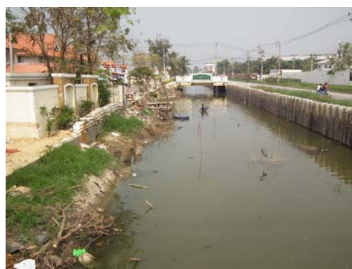
ภาพที่ 6-3 รูปถ่ายคลองหลังน้ำท่วม
