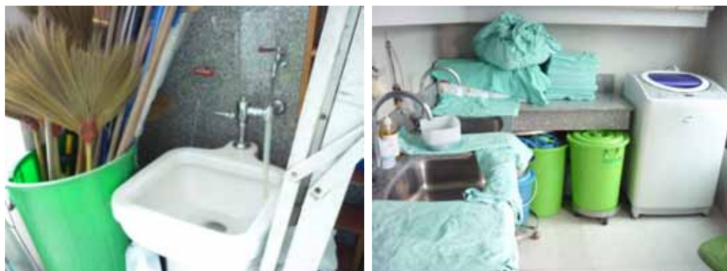
ภาพที่ 4-75 แสดงพื้นที่ห้อง Slop sink รวมสำหรับห้องผ่าตัดที่เชื่อมต่อกับเส้นทางสัญจรสกปรกแบบปิด ซึ่งจะมีอยู่ด้วยกัน 2 จุด
