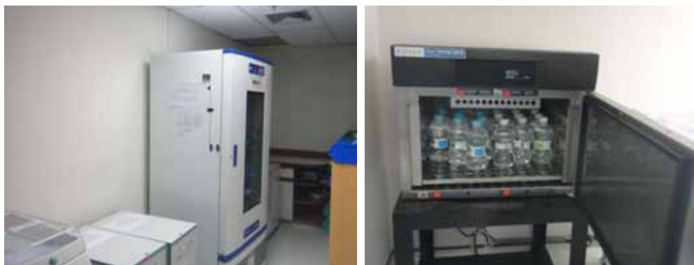
ภาพที่ 2-14 แสดงห้องเก็บเวชภัณฑ์ควบคุมอุณหภูมิ (โรงพยาบาลบำรุงราษฎร์ : 12 สิงหาคม 2554)
