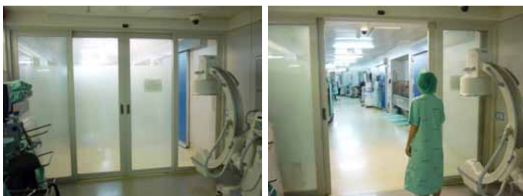
ภาพที่ 4-46 แสดงประตูบานเลื่อนอัตโนมัติกั้นระหว่างส่วน Intermediate Zone คือห้องผ่าตัดส่องกล้อง Endoscope และ Inner Zone คือพื้นที่ปลอดเชื้อเป็นห้องผ่าตัดทั่วไป โดยใช้ระบบความดันอากาศจัดให้พื้นที่ Inner Zone มีความดันมากกว่าเพื่อป้องกันเชื้อโรคจากส่วน Intermediate Zone แพร่กระจายเข้าไป
