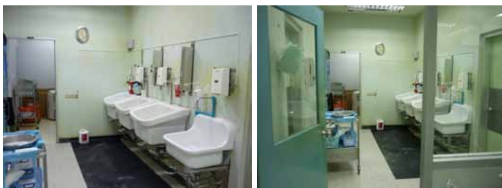
ภาพที่ 4-19 แสดงพื้นที่ Scrub Area สำหรับเจ้าหน้าที่บุคลากรทำความสะอาดมือก่อนเข้าสู่ห้องผ่าตัด ซึ่งจากบริเวณ Scrub Area นี้จะมีประตูเชื่อมต่อเข้าสู่ห้องผ่าตัดได้โดยตรง ดังจะเห็นประตูทางเชื่อมห้องไปห้องผ่าตัดจากรูปทางขวา ซึ่งส่วน Scrub Area ที่โรงพยาบาลศิริราชนี้จะมีจำนวนต่อห้องผ่าตัดเป็น 1:2
