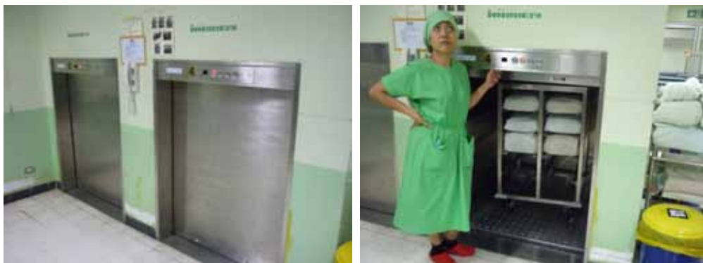
ภาพที่ 4-21 แสดงการขนส่งอุปกรณ์เครื่องมือที่ผ่านการอบฆ่าเชื้อจากหน่วยจ่ายกลางมายังห้องเก็บอุปกรณ์เครื่องมือปลอดเชื้อ หน่วยงานผ่าตัด ผ่านลิฟต์ปลอดเชื้อ
