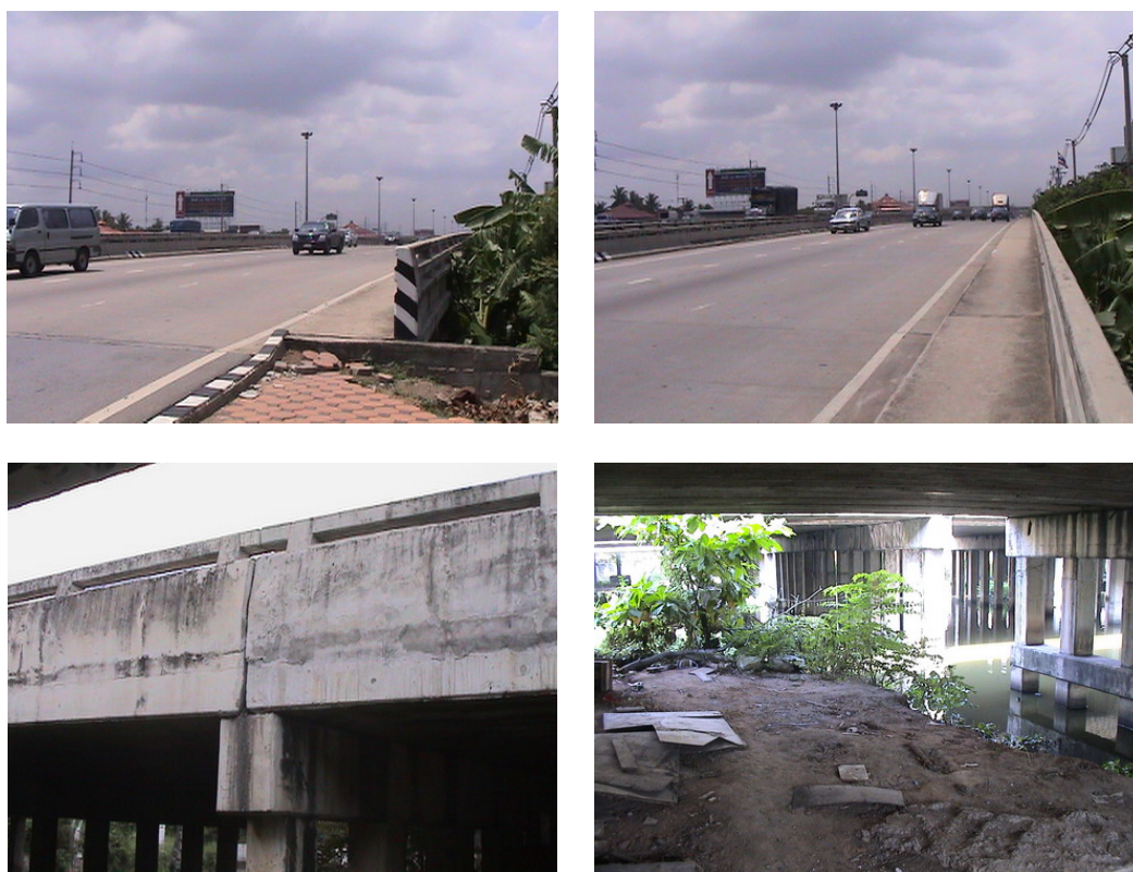
ภาพที่ 3.2 สะพานข้ามคลองบางน้อย (กม. 28+170.31 ถนนวงแหวนรอบนอกตะวันตก)
