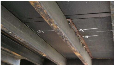
ภาพที่ 2.72 แสดงภาพ การเชื่อมแซมบริเวณ crossmember ที่ไม่เหมาะสม 2
