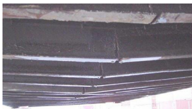
ภาพที่ 2.74 แสดงภาพ การซ่อมแซมบริเวณ crossmember ที่ไม่เหมาะสม 4
