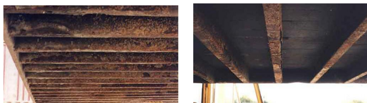
ภาพที่ 2.64 แสดงภาพสนิมโครงสร้างด้านล่าง
