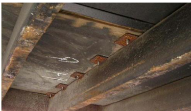
ภาพที่ 2.71 แสดงภาพ การเชื่อมแซมบริเวณ crossmember ที่ไม่เหมาะสม 1
