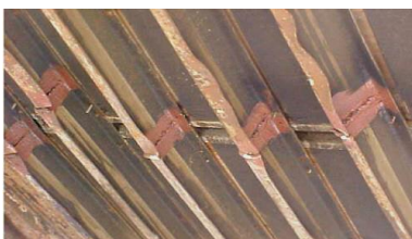
ภาพที่ 2.73 แสดงภาพ การเชื่อมแซมบริเวณ crossmember ที่ไม่เหมาะสม 3
