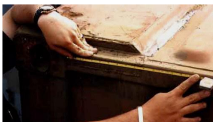
ภาพที่ 2.49 แสดงภาพการเสริมแพทช์ที่รางบนบริเวณมุมของตู้คอนเทนเนอร์
