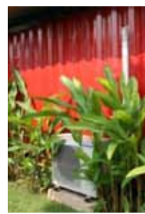
ภาพที่ 5.87 แสดงภาพคอนเดนซิ่ง ยูนิตบริเวณข้างอาคาร
