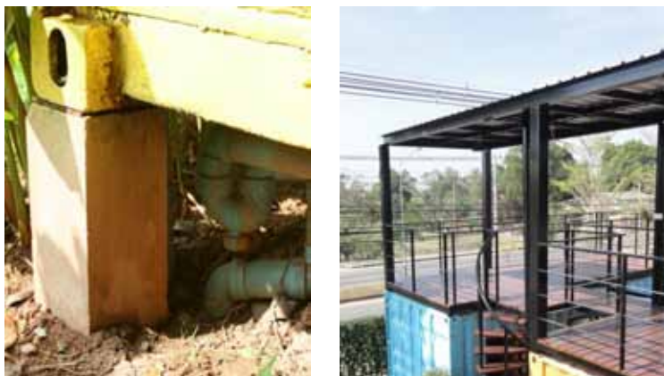
ภาพที่ 4.58 แสดงภาพโครงสร้างต่อม่อและเสาเหล็ก
