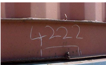
ภาพที่ 2.53 แสดงภาพความเสียหายส่วนล่างด้านข้างรางโครง 3
