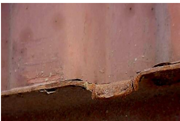
ภาพที่ 2.52 แสดงภาพความเสียหายส่วนล่างด้านข้างรางโครง 2
