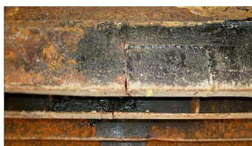
ภาพที่ 2.68 แสดงภาพการซ่อมแซมบริเวณ crossmember ที่ไม่เหมาะสม 2
