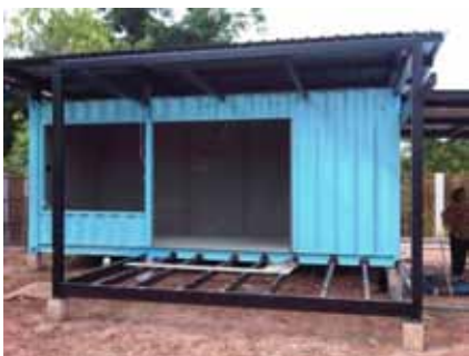
ภาพที่ 5.69 แสดงภาพระหว่างการก่อสร้างระเบียบชั้น 1
