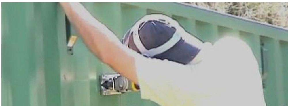
ภาพที่ 2.83 แสดงภาพการตัดผนังตู้คอนเทนเนอร์ด้วย Reciprocal Saw
