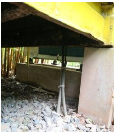
ภาพที่ 5.78 แสดงภาพการเดิน สายไฟเข้าด้านใต้ตู้คอนเทนเนอร์
