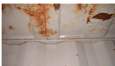
ภาพที่ 2.61 แสดงภาพร่องรอยการตกค้างของสารเคมี 1
