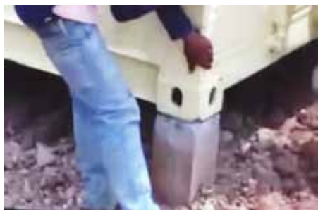
ภาพที่ 5.42 แสดงภาพการวางตัวตู้คอนเทนเนอร์กับเสาตอม่อคอนกรีต
