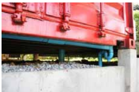
ภาพที่ 5.85 แสดงภาพการต่อท่อน้ำดีและ น้ำทิ้งใต้อาคาร
