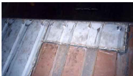
ภาพที่ 2.37 แสดงภาพการซ่อมแซมหลังคาที่ไม่เหมาะสม
