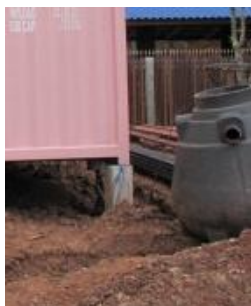
ภาพที่ 5.84 แสดงภาพถังบำบัดน้ำ เสียที่ใช้ในโครงการ
