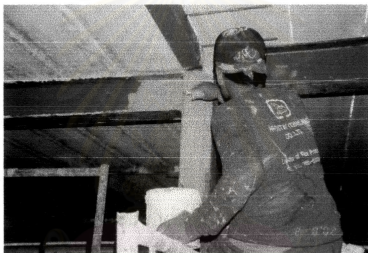
ภาพที่ 4-54 คนงานกำลังใช้แปรงทาสาร MII ให้ทั่วโครงสร้างเหล็กที่ต้องการ ก่อนงานพ่นสาร CP2
