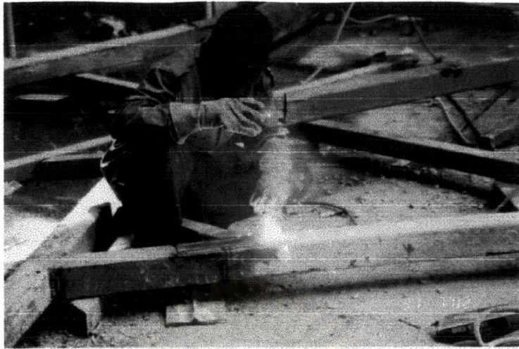
ภาพที่ 4-72 แรงงานเชื่อมที่ใช้ในการก่อสร้างอาคารโครงการยูเซ็นเตอร์
