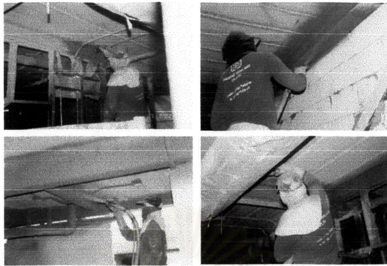
ภาพที่ 4-56 ภาพตัวอย่างขั้นตอนการพันสารกันไฟ CP2 ไปบนโครงสร้างเหล็กที่อาคาร MII ไว้แล้ว
