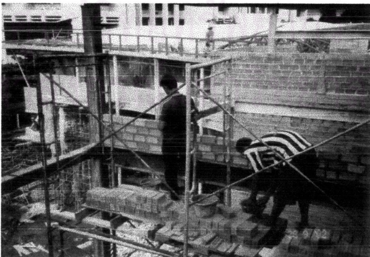
ภาพที่ 4-61 การใช้อิฐแดงชนิดกลางและอิฐมอญ มาใช้แทนอิฐมวลเบาในงานผนังอาคาร เนื่องจากเกิดปัญหาโรงงานผู้ผลิตอิฐมวลเบาไม่สามารถส่งวัสดุให้ได้
