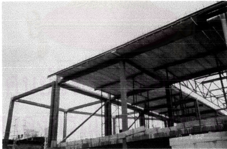
ภาพที่ 4-32 โครงสร้างพื้นชั้นดาดฟ้าใช้ระบบพื้นสำเร็จรูป วางเหล็กตะแกรง และเทคอนกรีตทับหน้า เช่นเดียวกับโครงสร้างพื้นอาคารส่วนชั้น 2 และชั้น 3
