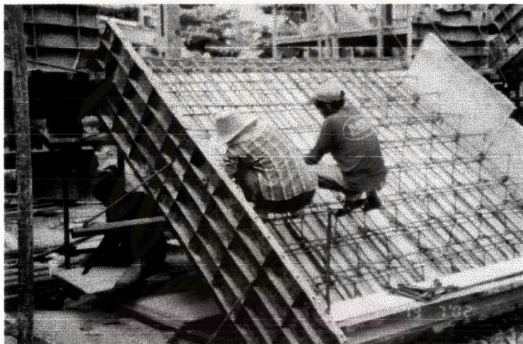
ภาพที่ 4-39 ขั้นตอนการผูกเหล็กเสริมท้องบ้านโคคคอนกรีตเสริมเหล็ก ทางชั้นอาคาร Zone B
