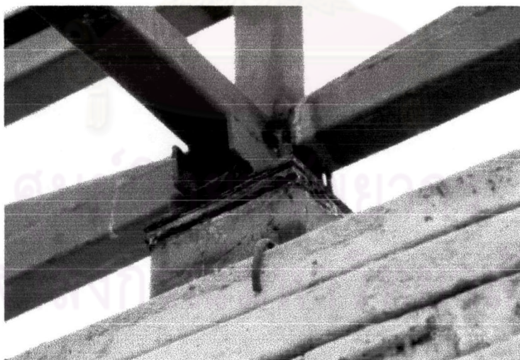
ภาพที่ 4-93 ปัญหาการติดตั้งโครงหลังคาเหล็กไม่ได้ระดับ
