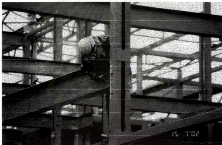
ภาพที่ 4-73 ช่างฝีมืองานเชื่อม ที่ทำการเชื่อมต่อโครงสร้างในส่วนที่สำคัญและต้องการคุณภาพสูง
