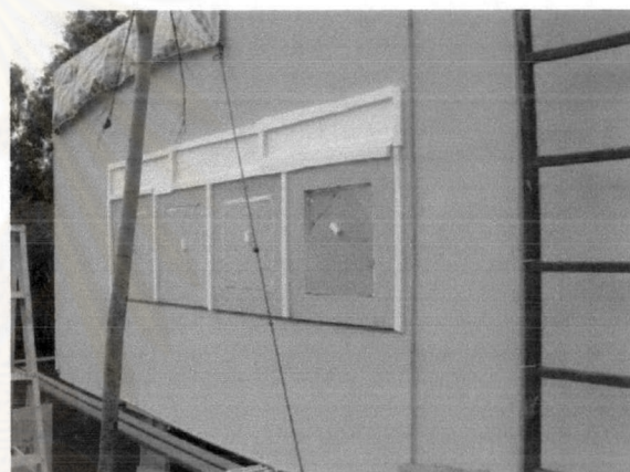
ภาพที่ 3-14 วัสดุทดสอบติดตั้งบนอาคารทดลอง
