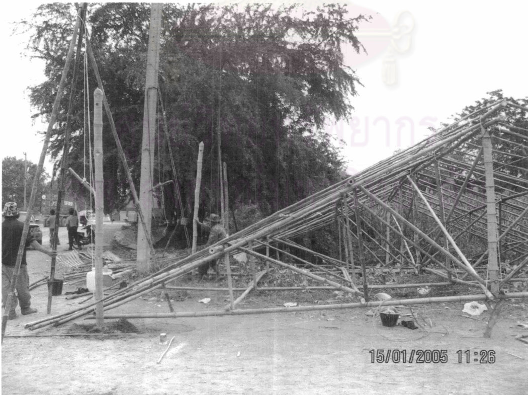
ภาพที่ 7.38 แสดงการติดตั้งเสาและเสริมด้วย เศษ หินและอิฐลงไปในหลุม (3)
