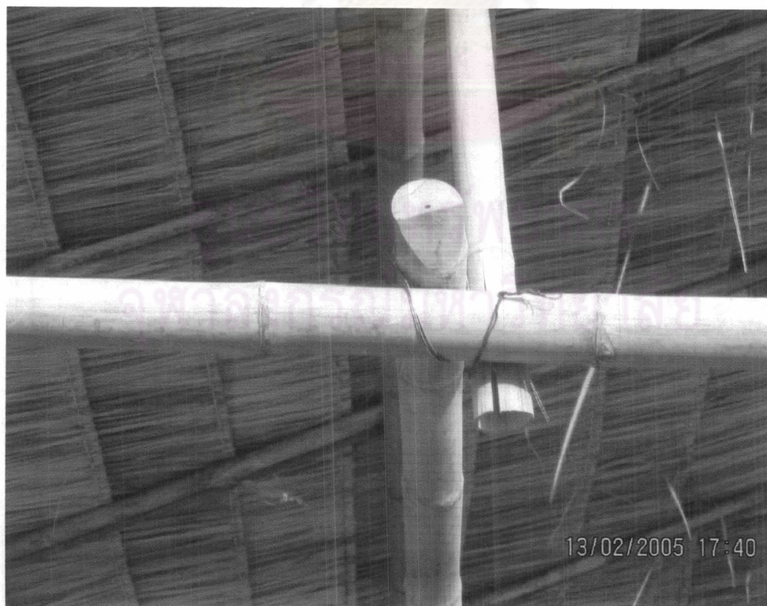
ภาพที่ 7.78 แสดงความเสียหายของโครงสร้างหลักการแขวนน้ำหนัก 400 กิโลกรัม
