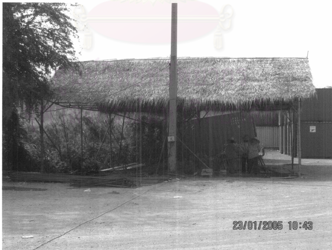
ภาพที่ 7.54 แสดงการมุงหลังคาแล้วเสร็จ (3)
