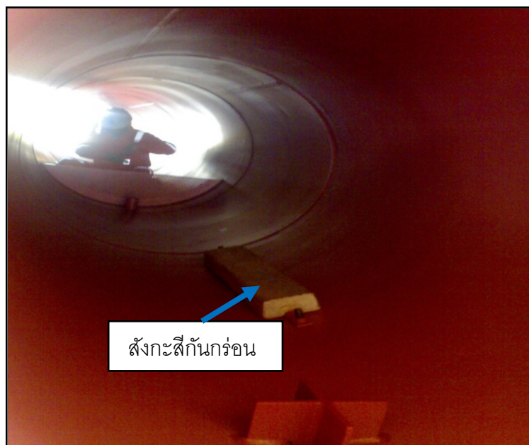
ภาพที่ 1.1 สังกะสีกันกร่อน (Zinc Anode) ที่ใช้ป้องกันการกัดกร่อนของเครื่องเก็บน้ำ บนแท่นบงกช
