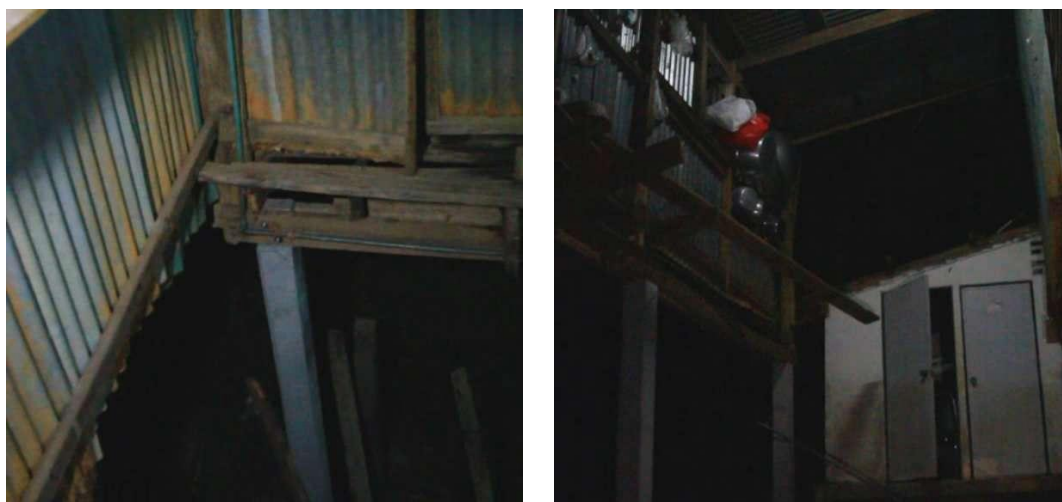
รูป 5-22 การติดบ้านที่ไม่ประสบความสำเร็จเนื่องจากคานเสื่อมสภาพ : ที่มาจากรายงานครอบครัวข่าว 3
