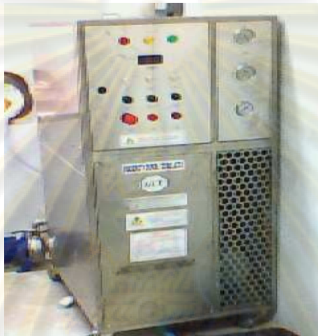
รูปที่ 5.4 เครื่องทำความเย็น (Chiller)
