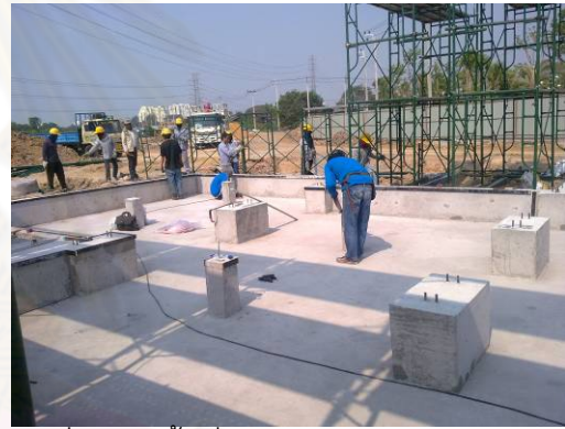
ภาพที่ 5-19 พื้นที่หลังจากเทคอนกรีตแล้วเสร็จ
