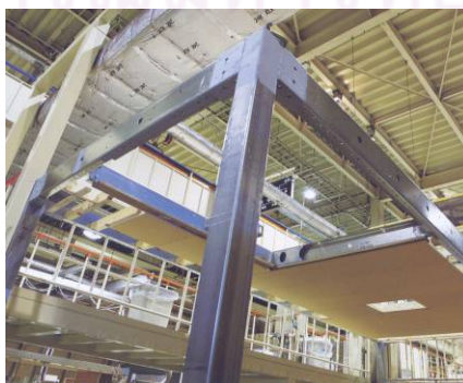
ภาพที่ 5-6 โครงสร้างที่ทำการเชื่อมแล้วเสร็จ
