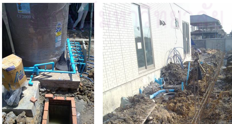
ภาพที่ 5-52 การติดตั้งถังน้ำดี และถังบำบัดน้ำเสีย
