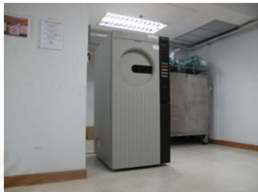
ภาพที่ 4.33 บริเวณติดตั้งเครื่องทำให้ปราศจากเชื้อชนิด Hydrogen peroxide Gas Plasma
