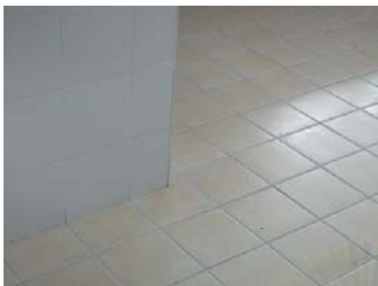
ภาพที่ 4.76 ผนังและพื้นภายในห้องล้างอุปกรณ์ฯ
