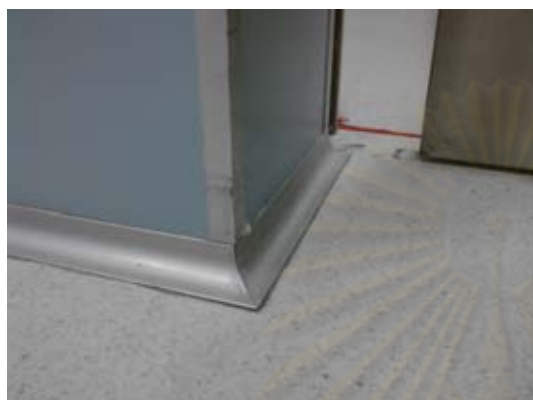
ภาพที่ 4.102 พื้นและผนัง ห้องผ่าตัดที่ใช้เป็นห้องเก็บอุปกรณ์ปราศจากเชื้อ
