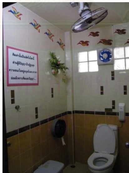
ภาพที่ 4-17 มีการติดตั้งพัดลม และเครื่องดูดอากาศภายในห้องน้ำทุกห้อง
