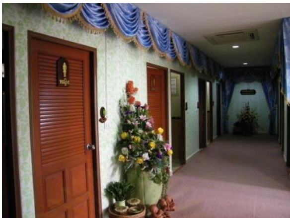
ภาพที่ 4-18 ติดตั้งเครื่องฟอกอากาศบริเวณทางเดิน
