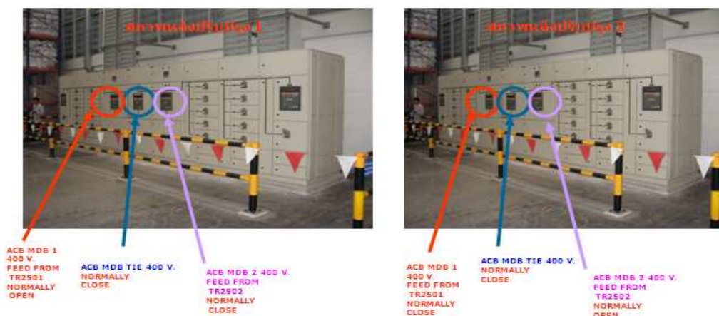
รูป 5.19 MDB ด้านแรงดันต่ำสถานะการใช้งานในการย้ายโหลดหลังดำเนินการมาตรการ
