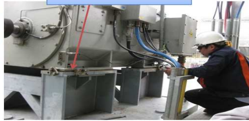
ด้านที่เกิด soft foot มากกว่าด้านอื่น
