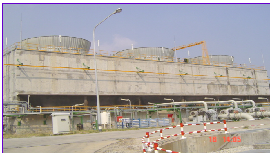
รูป 5.1 Cooling Tower และปั๊มน้ำติดตั้งในโรงงานปิโตรเคมีกรณีสึกษา
