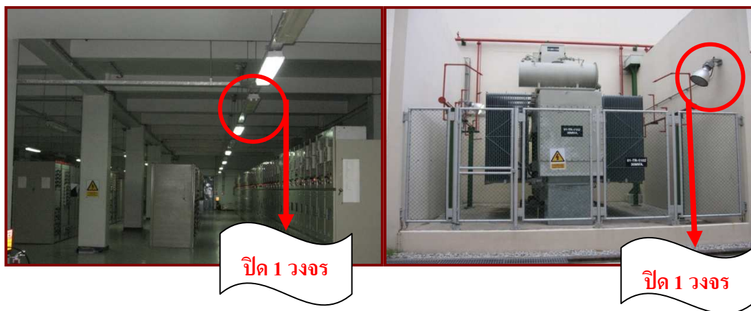
รูป 5.25 ระบบแสงสว่างห้องหม้อแปลงไฟฟ้า หลังปรับปรุง
