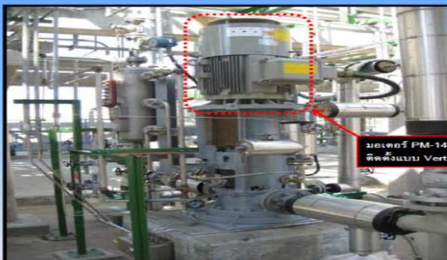
ลักษณะการติดตั้งมอเตอร์ PM-1440A (Debutanizer Reflux Pump Motor)
