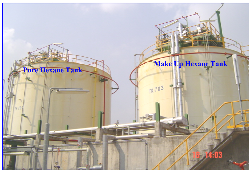
รูป 5.10 Storage Tank Hexane ที่ใช้ในกระบวนการผลิต
