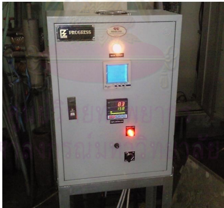
รูปที่ 4.24 แผงควบคุมการทำงานของชุดฮีตเตอร์ไฟฟ้า
