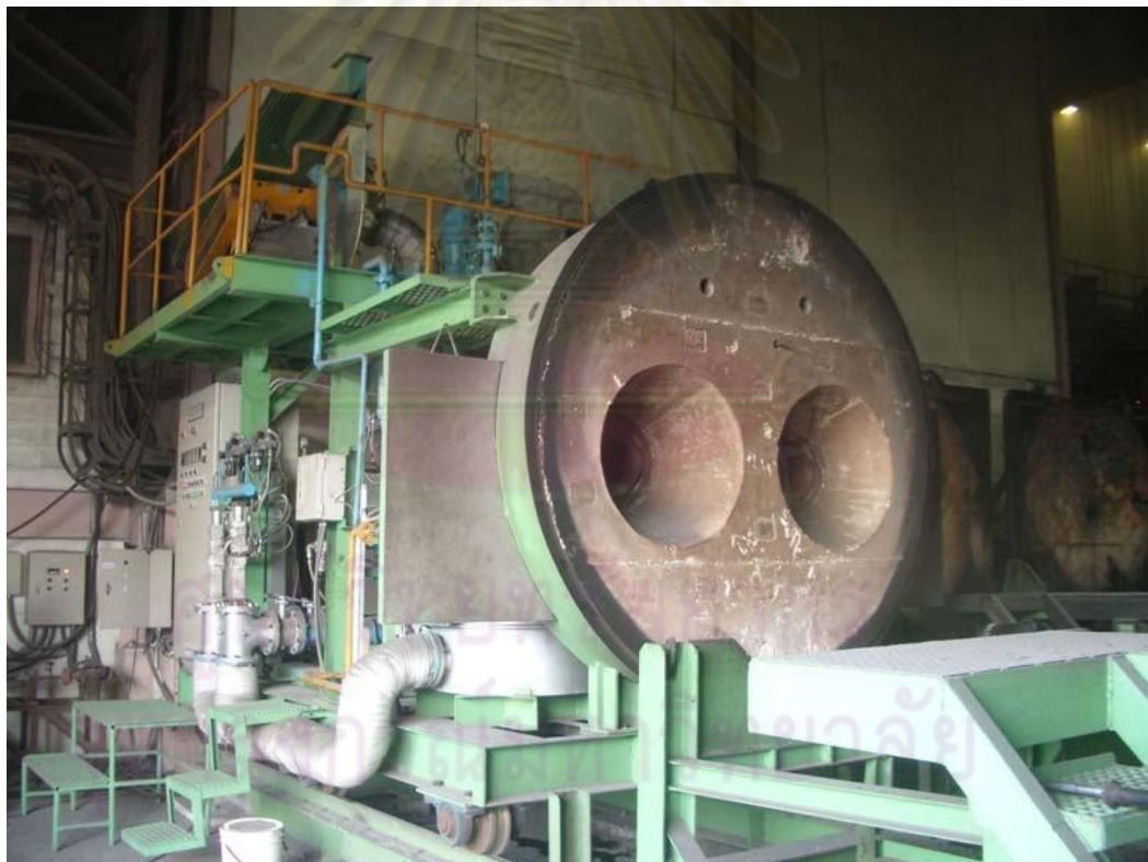
รูปที่ 2.1 หัวเผารีเจนเนอเรทิฟที่ออกแบบและติดตั้ง (จักรวรุช จรุงสารทูล และคณะ, 2552)
