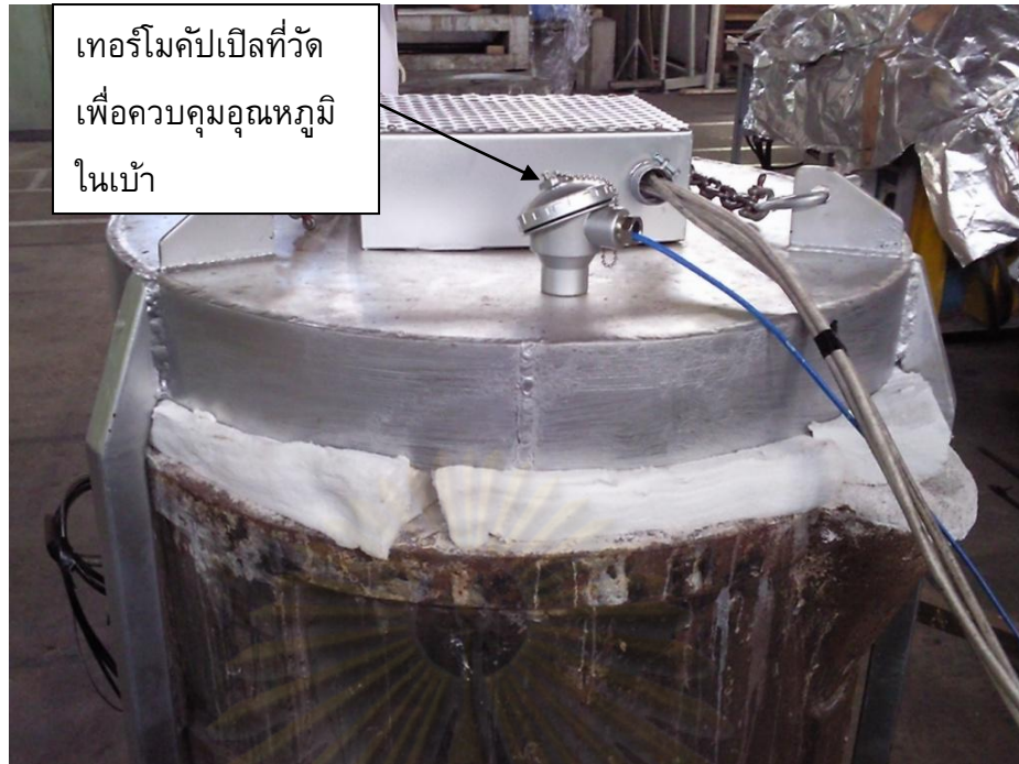
รูปที่ 4.29 เทอร์โมคัปเปิลที่วัดอุณหภูมิภายในเบ้าเพื่อใช้ในการควบคุมการทำงานของชุดฮีตเตอร์ไฟฟ้าในขณะที่ทำการอุ่นเบ้า
