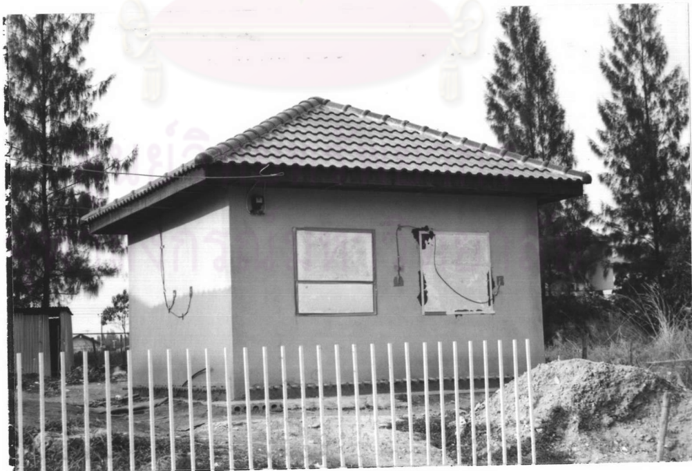
รูปที่ 28 แสดงสภาพภายนอกอาคารทางด้านทิศใต้
