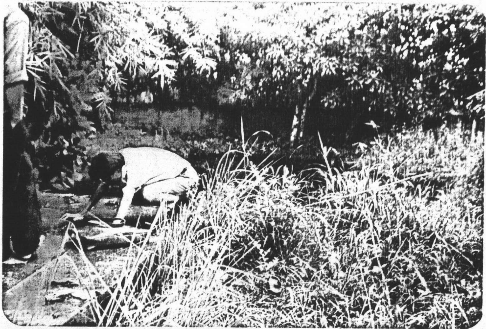
ภาพที่ 4.68 สภาพภายนอกของถังกรวดกรองของการประปาบ้านเพี้ย ซึ่งก่อสร้างไว้บริเวณริมอ่างน้ำซับ
