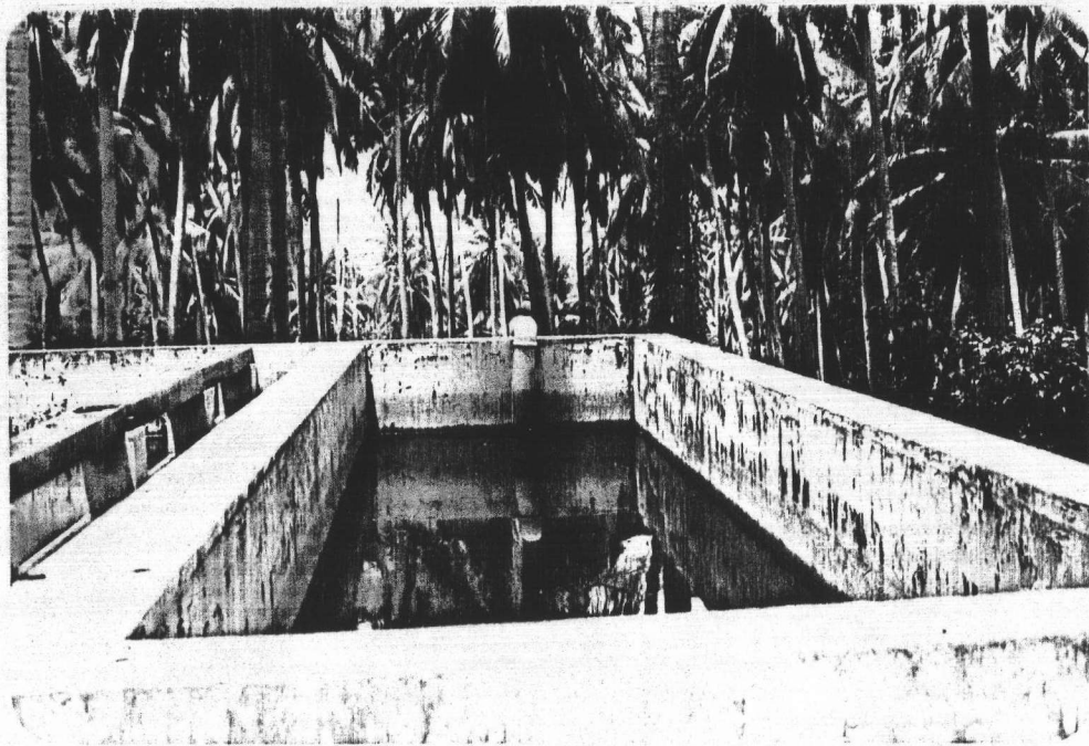
ภาพที่ 4.15 สภาพถังพักน้ำดิบและท่อน้ำเข้าถังกรองการประปาสุขาภิบาล เกาะสมุย
