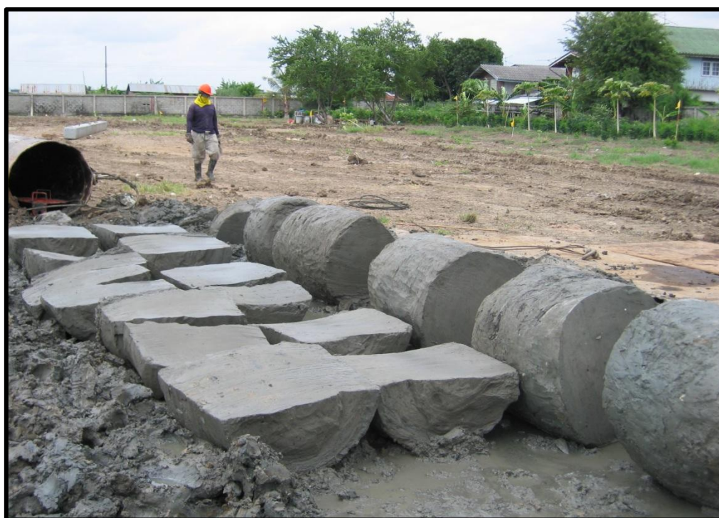
ภาพที่ 2.16 การทดสอบดึง-ถอนเสาเข็มดิน-ซีเมนต์
