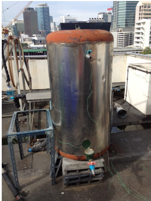
รูปที่ 3.10 ถังเก็บน้ำร้อน
