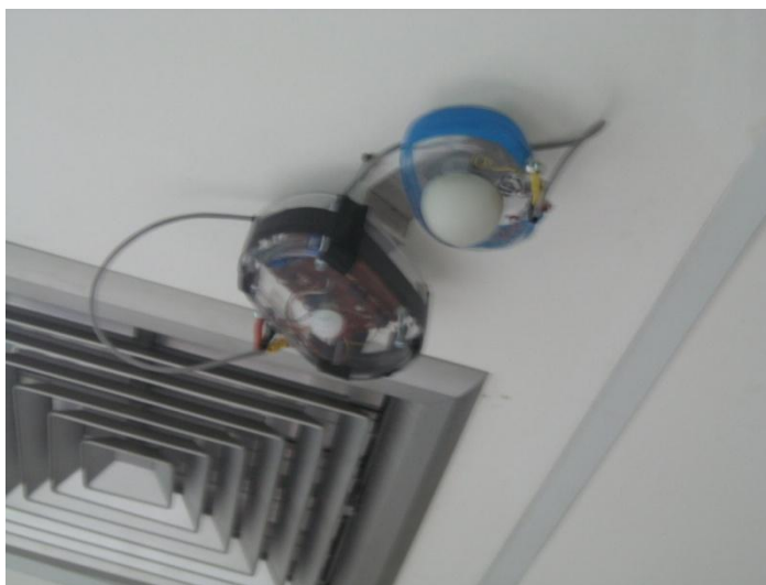
ภาพที่ 4.14 กลุ่มของ Sensor 1 ที่ติดตั้งบนเพดานของห้องทำงาน
