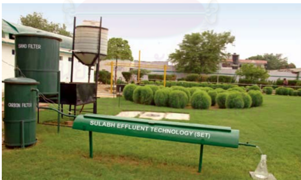
ภาพที่ 2-24 ภาพระบบของ Sulabh Effluent Treatment (SET)
