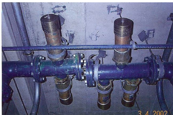
ภาพที่ 2.5 แสดงตัวอย่างการติดตั้งอุปกรณ์ป้องกันน้ำกระแทกเหนือฝ้าเพดานห้องน้ำ
