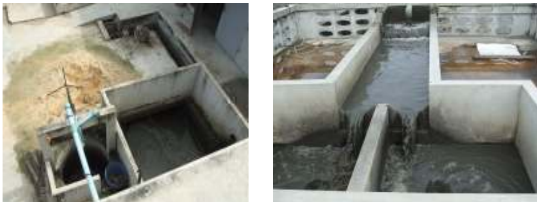
รูปที่ 2.2 ลักษณะน้ำเสียและการรวบรวมน้ำเสียลงสู่บ่อรวมน้ำเสียก่อนการบำบัด
