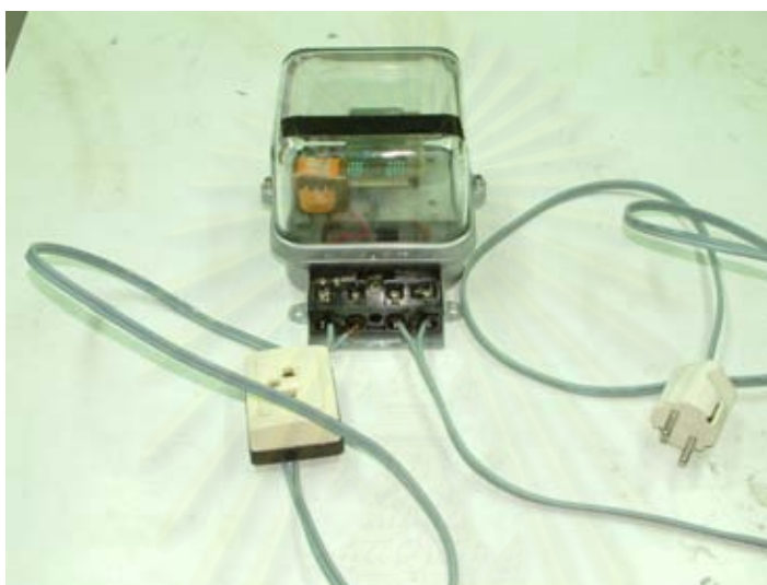
รูปที่ 3.10 เครื่อง TOU Meter ใช้ในการวัดพลังงานที่ใช้ ปั่นดิน
